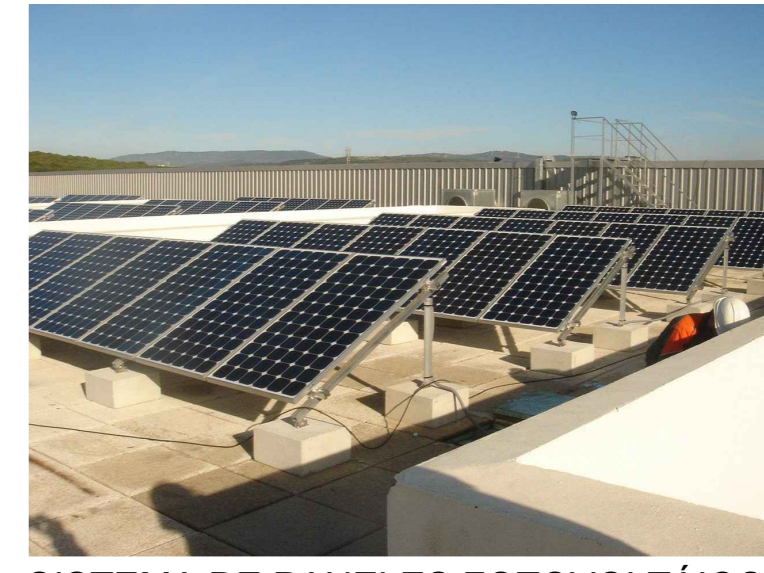
SISTEMA DE PANELES FOTOVOLTAICOS
