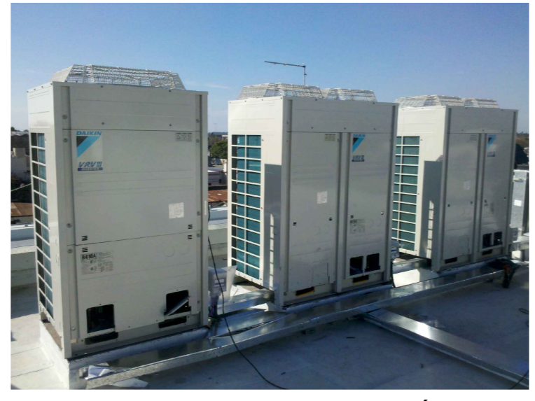
SISTEMA VRV DE CLIMATIZACIÓN
